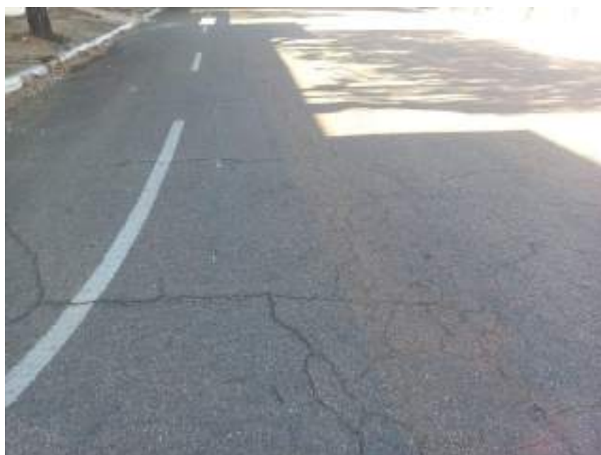
Figura 21- Defeitos Avenida Sete Copas
