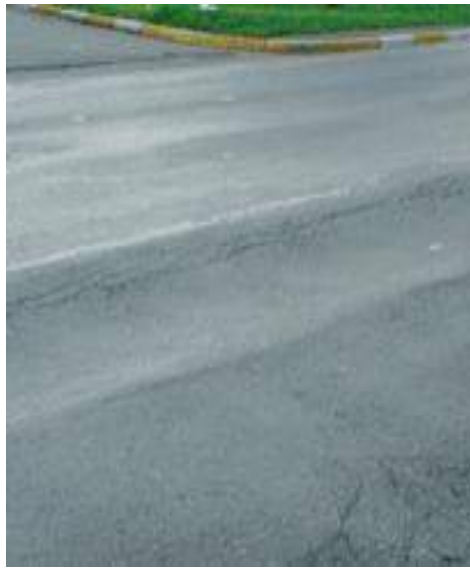
Figura 9 - Afundamento de trilha de roda
