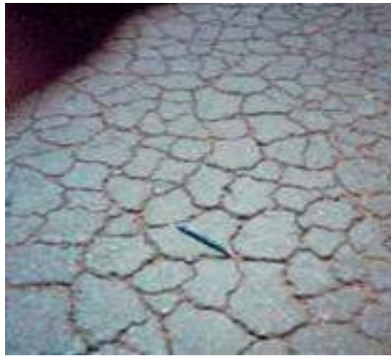
Figura 7 - Trinca couro de jacaré
