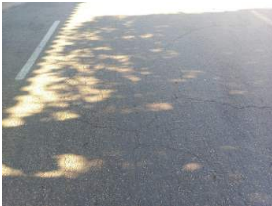
Figura 20- Defeito Avenida sete copa
