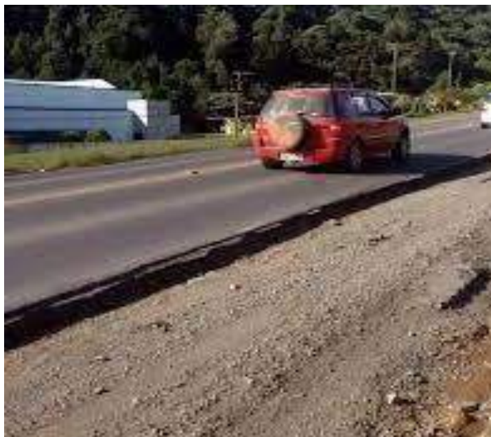
Figura 16 - Desnível entre a pista e acostamento
