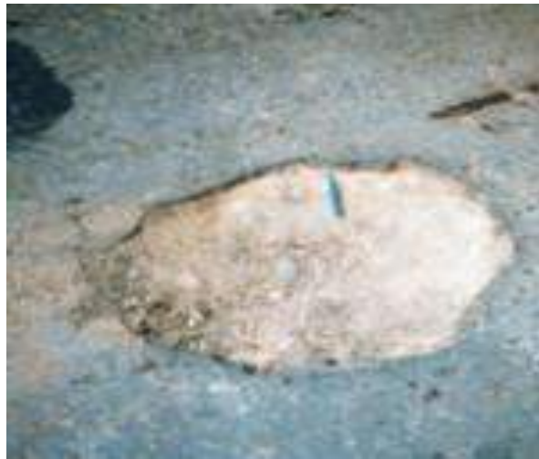
Figura 14 - Buraco ou Panela
