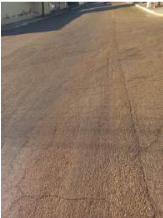
Figura 22- Defeitos Avenida Sete Copas
