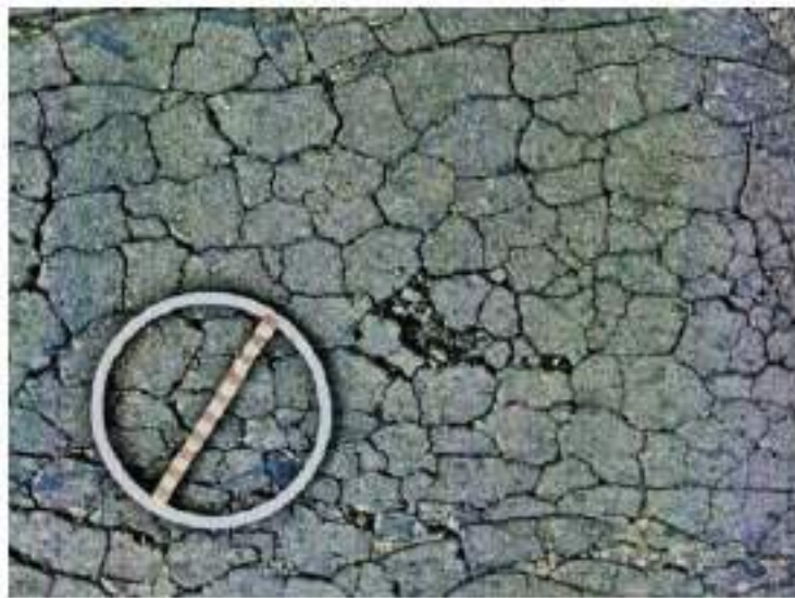
Figura 8 - Trinca couro de jacaré
