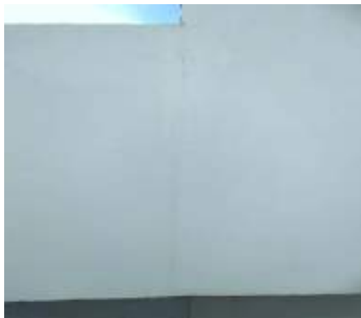
Figura 2: Imagem da fissura
